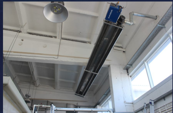
Помещение по очистки сточных вод
